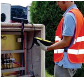
Inyección de señal con el transmisor IC1G-TX
